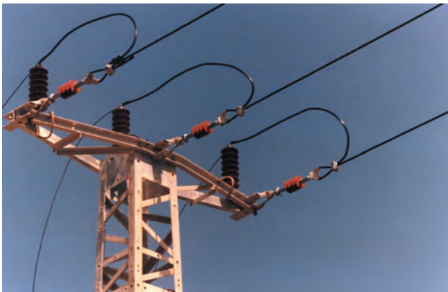
Zugisolator in Verbundbauweise
